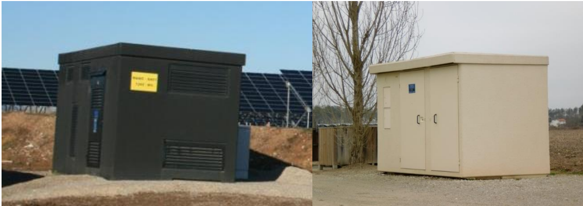
Figure 11 : Exemple de locaux techniques
